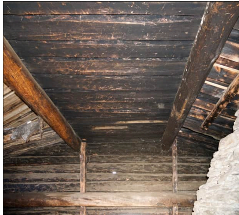
→ Fig. 155: Savun jälkeä seinissä ja alakatossa FI-kuvat, 2024
